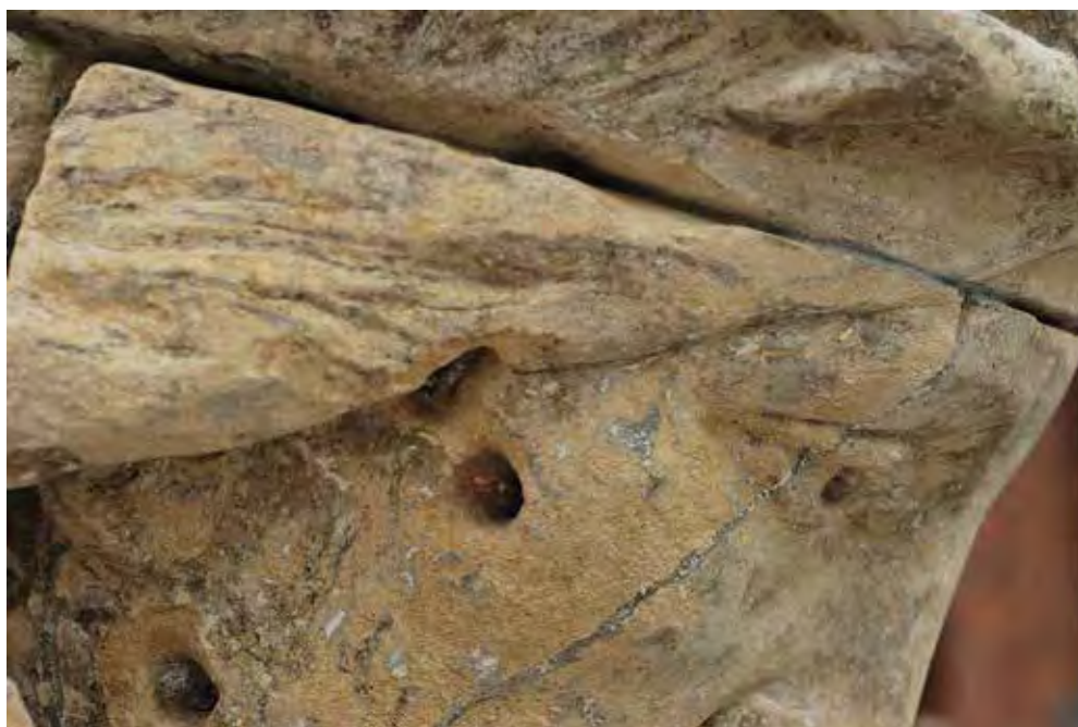
Fot. 6. Miejsce użycia metalowych gwoździ w celu przytwierdzenia odspojonych fragmentów głowy. Głębokie otwory wokół stalowych prętów powstały na skutek osłabienia kamienia przez zastosowania niezabezpieczonych elementów metalowych.
