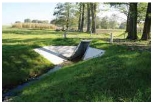
Zdj. 13, 14, 15. Rowy odpływowe z drenowania wraz z budowlami we wsiach, od góry: Uścianek-Dębianska, Jasienica, Chmielewo.
