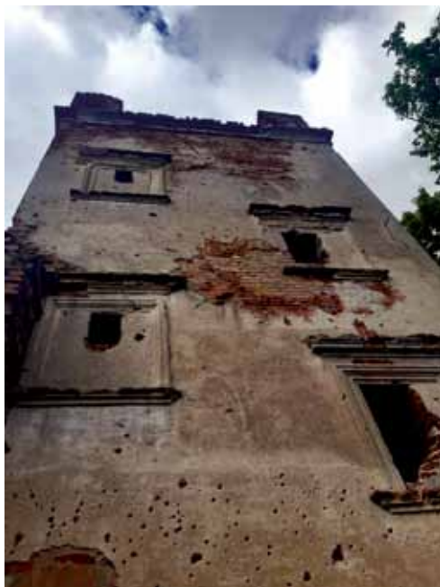
Ryc. 17. Ruiny klatki schodowej pałacu biskupiego w Broku – widok od strony wschodniej.
